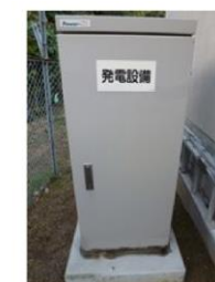
(非常用発電機の写真)
