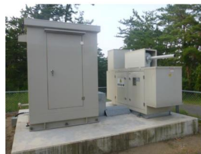
(モニタリング・ポスト用発電機の写真)
