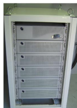
無停電電源装置
