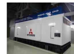
(常設代替交流電源設備の写真)
