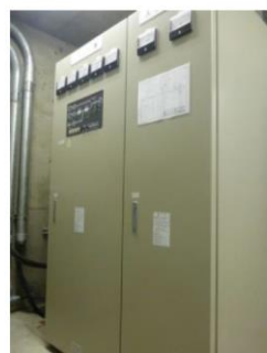
(無停電電源装置の写真)
