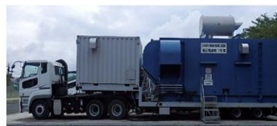
常設代替交流電源装置
