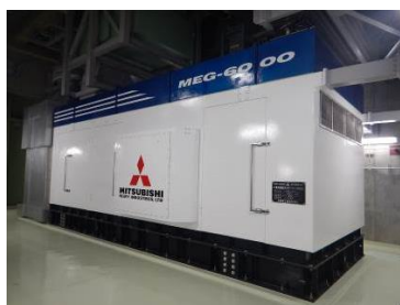
(常設代替交流電源設備の写真)
