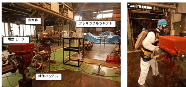
ベント操作（遠隔手動弁操作機構）
