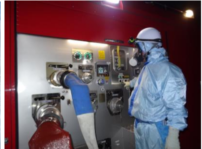
ポンプ起動操作（夜間）
