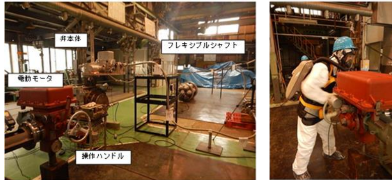
ベント操作（遠隔手動弁操作機構）
