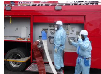
ポンプ起動操作（昼間）
