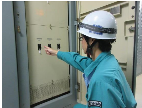
電源切替操作
