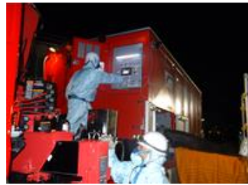
ポンプ起動操作（夜間）
