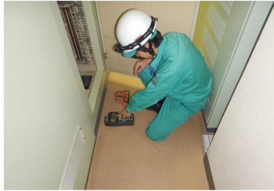
電池容量確認
