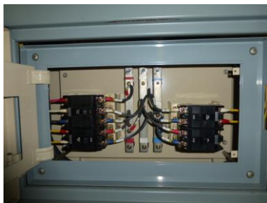
気中遮断器の例 (ブレーカ)
