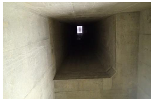
A-給気消音器フィルタ室内
