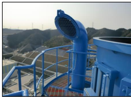
非常用ガス処理系用排気筒 端部状況
