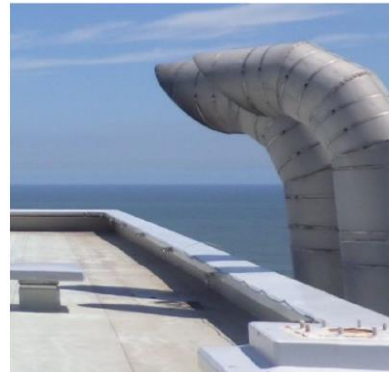
第5図 ディーゼル発電機排気管
