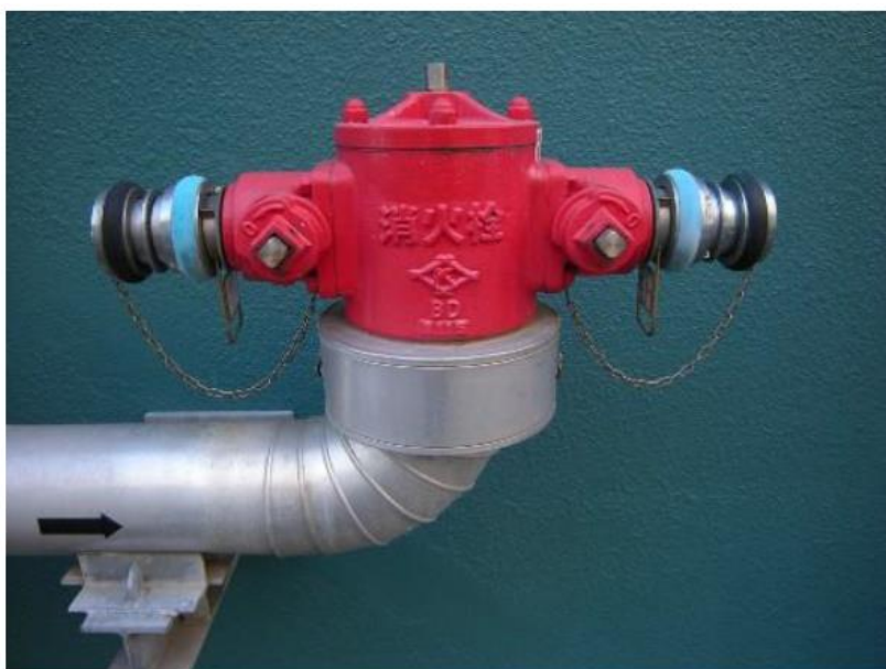
第 1-32 図：不凍式消火栓の設置状況
