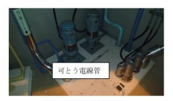
機器へのケーブル取合い (サンプポンプ、レベル計との取合い)
