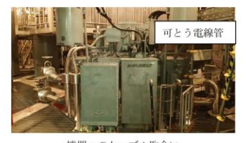
機器へのケーブル取合い (原子炉再循環ポンプ用電動機との取合い)
