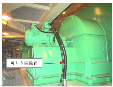
機器へのケーブル取合い状況 (D/W冷却機との取合い)
