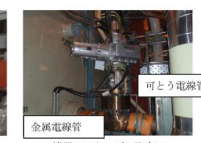
機器へのケーブル取合い (電動弁との取合い)
