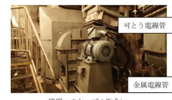
機器へのケーブル取合い (ドライウェル冷却機との取合い)
