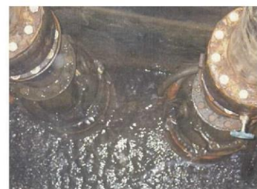
2号炉揚水ポンプの例(揚水井戸⑥)
