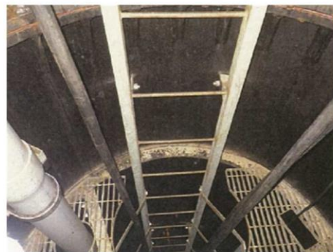
写真B 揚水井戸⑦(中間部) 2017/3/16撮影
