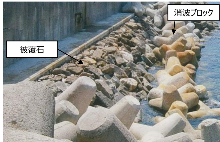
被覆石設置状況（1，2号炉北側護岸） 第2-13 図 被覆石の寸法及び設置状況
