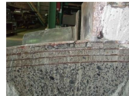
引張縁破断状況
