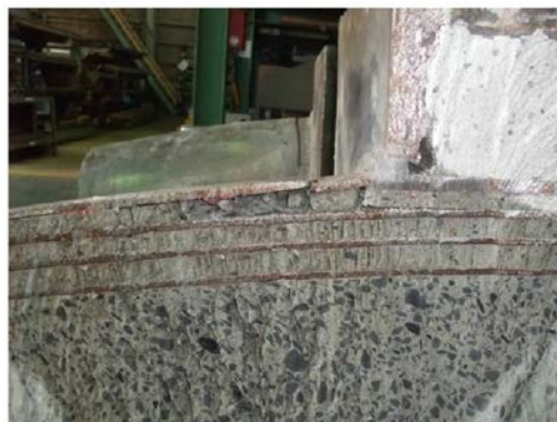
引張縁破断状況
