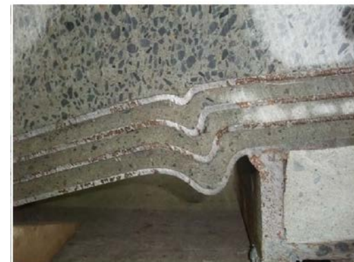
圧縮縁はらみ出し状況
