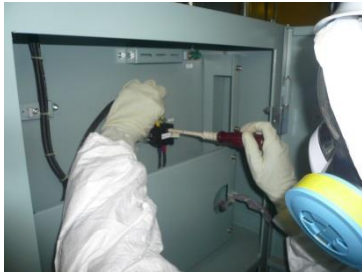
主蒸気逃がし安全弁用 蓄電池へ接続
