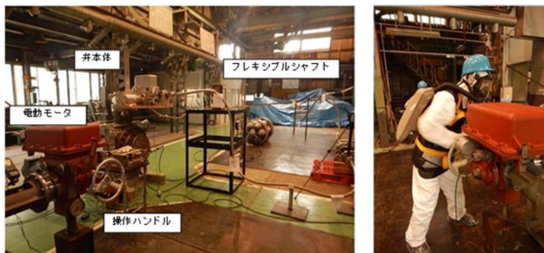
ベント操作（遠隔手動弁操作機構）
