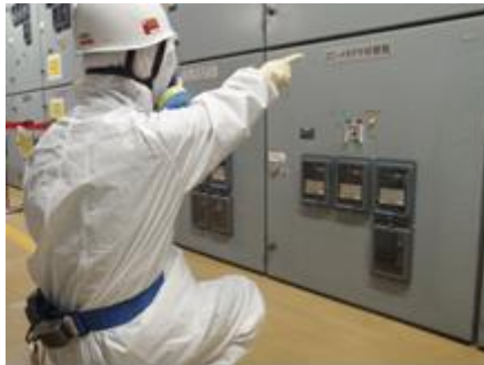
遮断器手動投入
