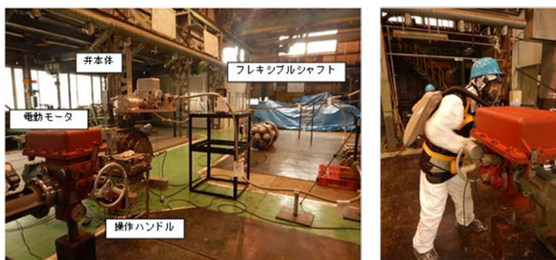
ベント操作（遠隔手動弁操作機構）
