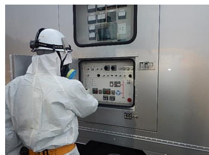
高压発電機車での作業
