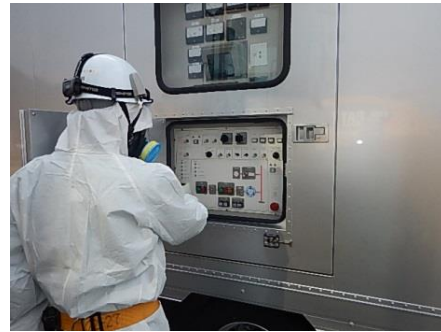
高圧発電機車での作業
