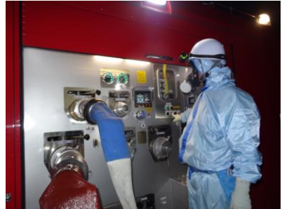
ポンプ起動操作（夜間）
