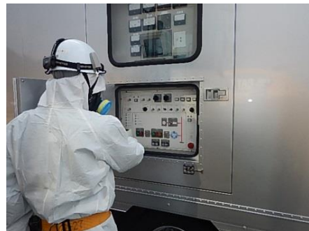
高圧発電機車での作業
