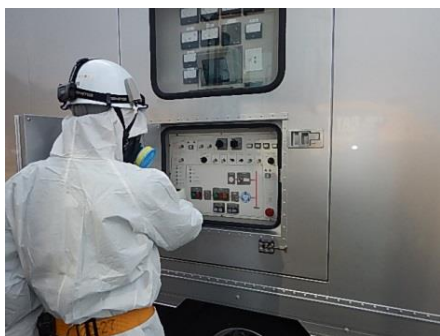
高圧発電機車での作業
