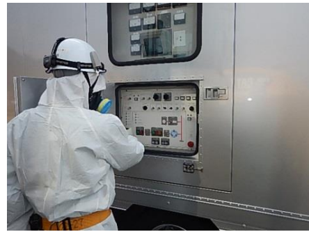
高圧発電機車での作業
