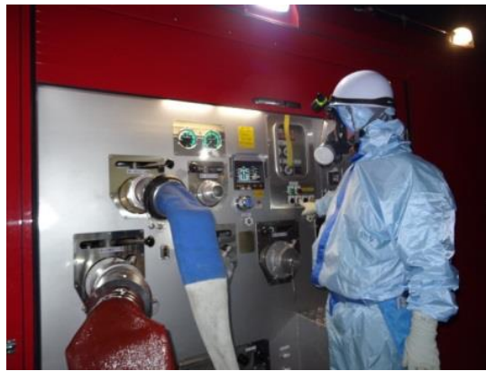
ポンプ起動操作（夜間）
