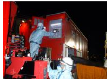
ポンプ起動操作（夜間）
