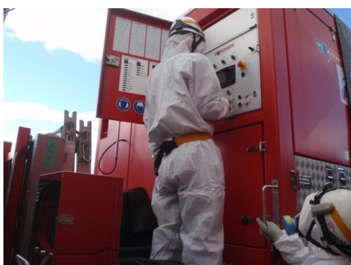
ポンプ起動操作
