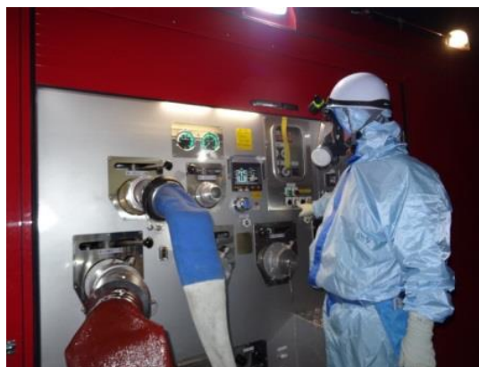
ポンプ起動操作（夜間）
