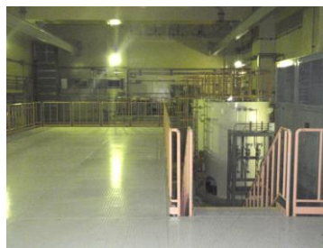
RCW サージタンク及び 計器ラック
