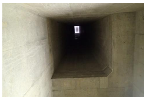
A-給気消音器フィルタ室内
