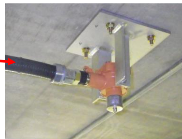
水素濃度検知器（拡大）
