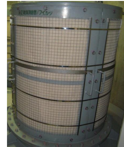
第 6-2 図 非常用ディーゼル発電機給気消音器フィルタ
