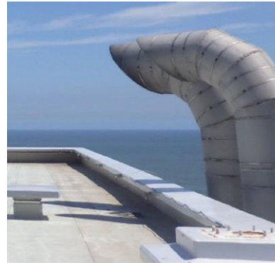
第5図 ディーゼル発電機排気管
