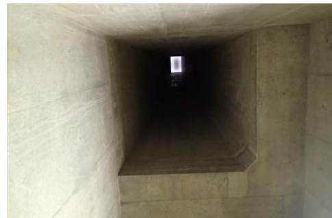
A-給気消音器フィルタ室内
