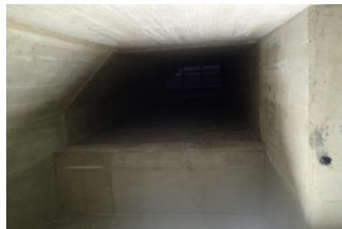
H P C S 給気消音器フィルタ室内
