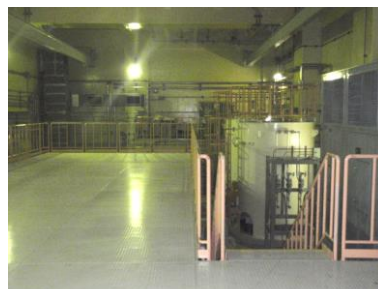
RCW サージタンク及び 計器ラック
