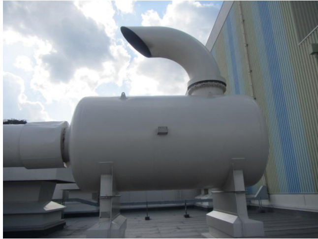
第 3-3 図 ディーゼル発電機排気消音器及び排気管
