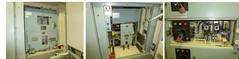
真空遮断器の例 (メタクラ)
