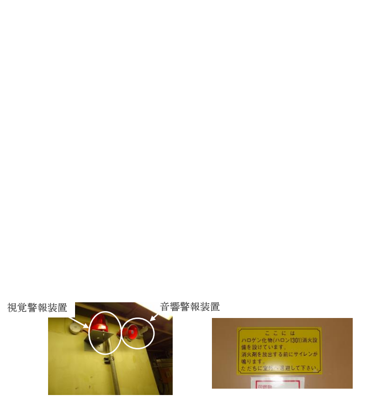
第 1-29図 全域ガス消火設備の職員退避警報装置の例
