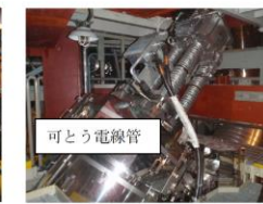
機器へのケーブル取合い (主蒸気内側隔離弁との取合い)
