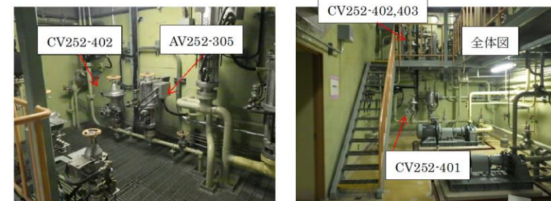
第9-11図 液体廃棄物処理系(床ドレン化学廃液系)の弁配置状況
