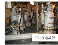
機器へのケーブル取合い (主蒸気速がし安全弁との取合い)
