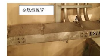
金属製の密閉ダクト (蓋付きケーブルトレイ)
