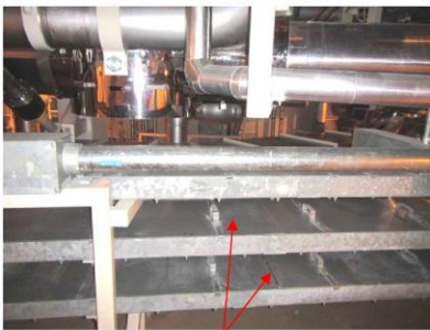
金属製の密閉ダクト (蓋付きケーブルトレイ)
