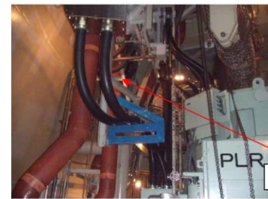
機器へのケーブル取合状況 (PLR との取合)
