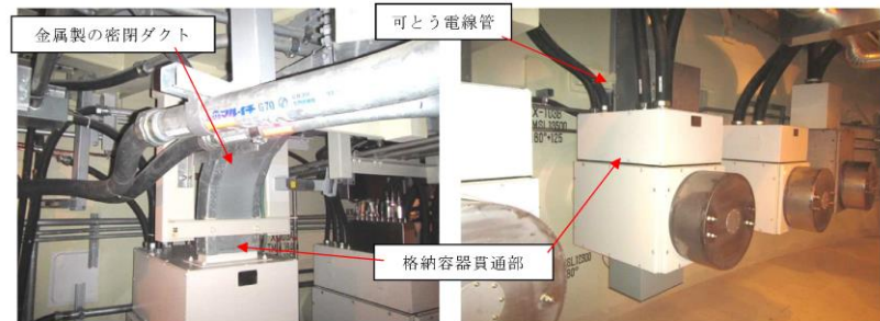
機器へのケーブル取合い状況 (格納容器貫通部とケーブルトレイ・電線管との取合い)
