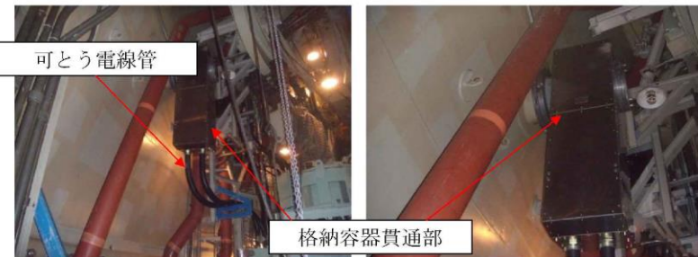
機器へのケーブル取合状況 (格納容器貫通部と電線管との取合)
