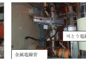
機器へのケーブル取合い (電動弁との取合い)
