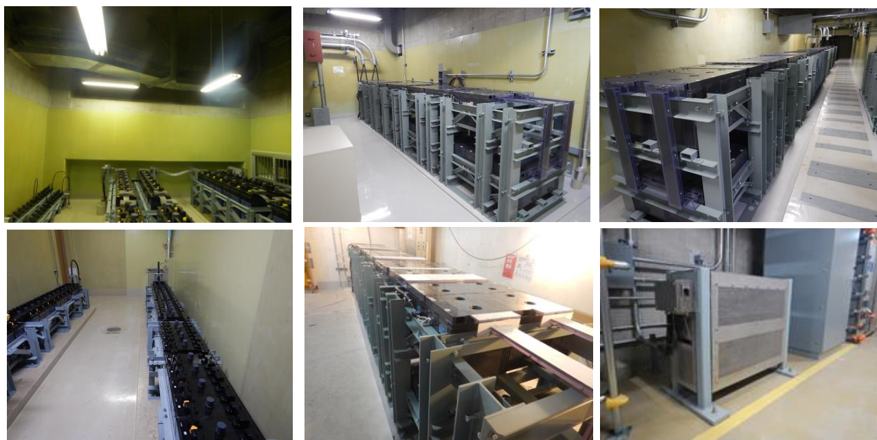
第1-39図 蓄電池の設置状況 (1 / 7)
