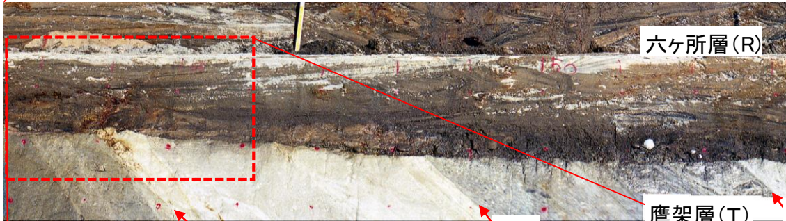
f-1断層 断層 断層 f-1断層全景写真
