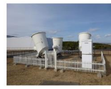
【ドップラーソーダ (風向風速計)】 (排気筒高さ)
