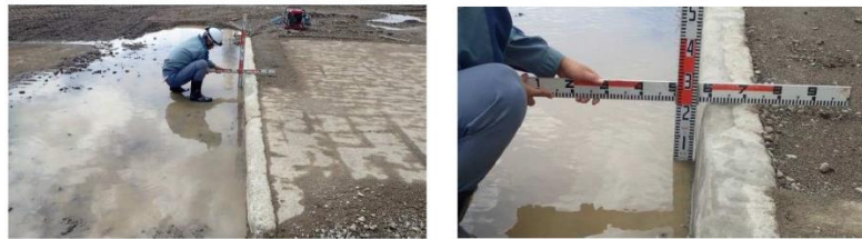
復旧前の段差状況
