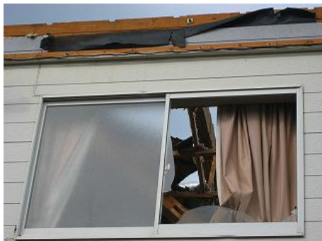
写真 19 窓ガラスの損壊
