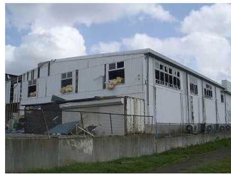
写真 16 窓ガラスの破損
