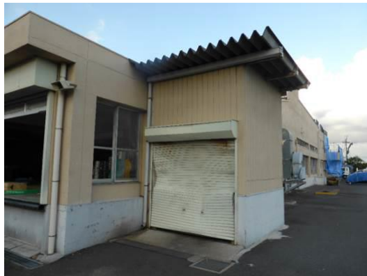
写真 4.1.30 シャッターの変形
