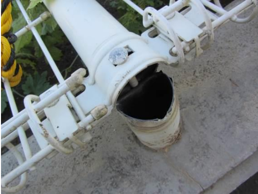
写真 4.1.15 支柱部の破断
