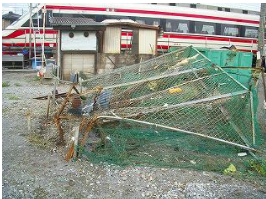
写真20 フェンスの著しい変形
