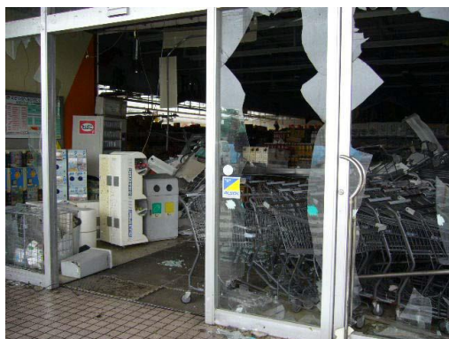
写真 8 エントランスの窓ガラスの破損
