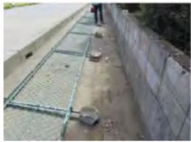
フェンスの倒壊
