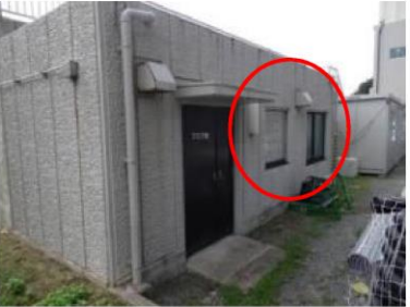
71 ブロワ室ガラス窓
