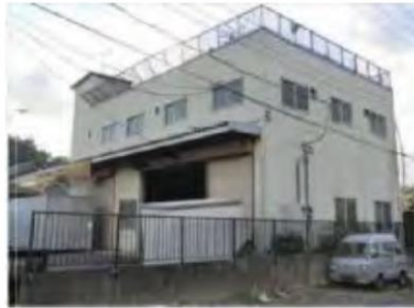
屋上フェンスの被害
