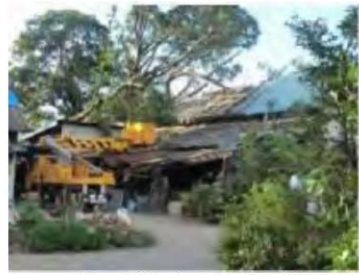
樹木の倒壊による小屋組の被害
