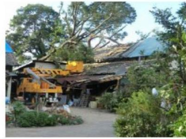
樹木の倒壊による小屋組の被害
