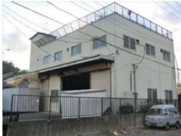
屋上フェンスの変形
