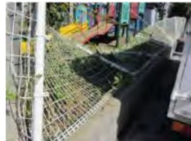
フェンスの倒壊
