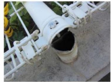
フェンス支柱部の破損
