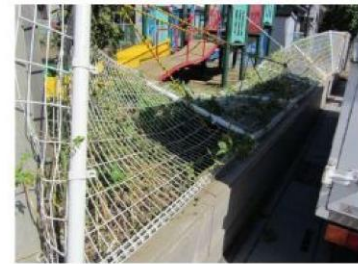
フェンスの変形
