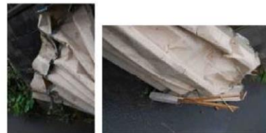
飛散した折板屋根の損傷状況
