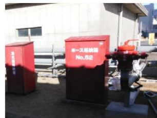
#153 消火設備格納箱
