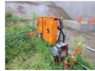
③-3 仮設分電盤
