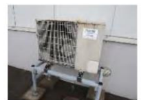
④-14 空調室外機
