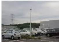
④-6 屋外照明
