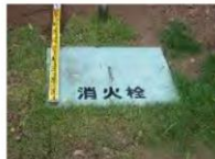
③-10 消火栓蓋
