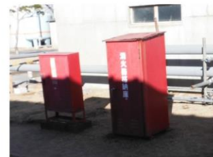
#152 消火設備格納箱
