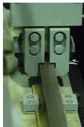
燃料取替機（トロリ）脱線防止ラグ
