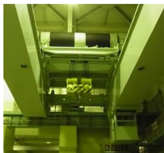
原子炉建物天井クレーン外観
