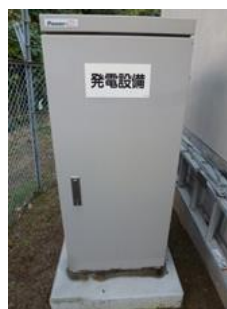
(非常用発電機の写真)
