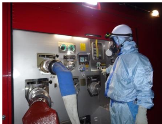
ポンプ起動操作（夜間）
