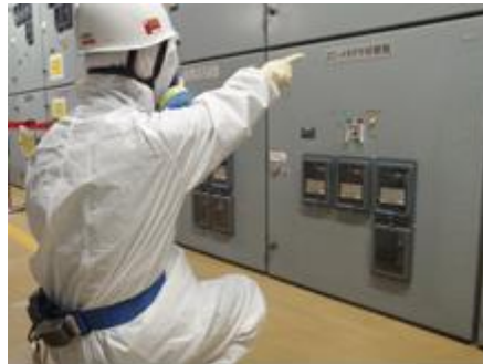
遮断器手動投入
