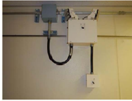
第7図 電源内蔵型照明
