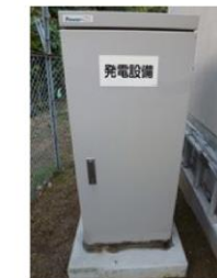
(非常用発電機の写真)
