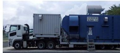
常設代替交流電源装置
