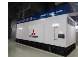
(常設代替交流電源設備の写真)
