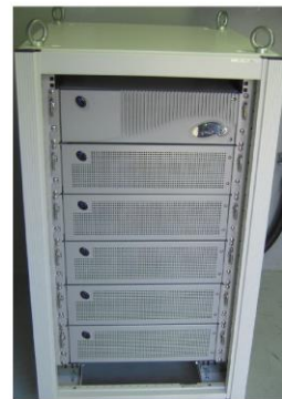
無停電電源装置
