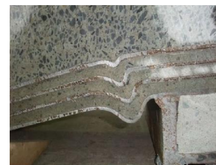
圧縮縁はらみ出し状況
