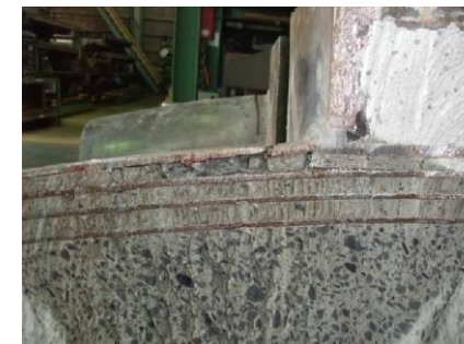
引張縁破断状況
