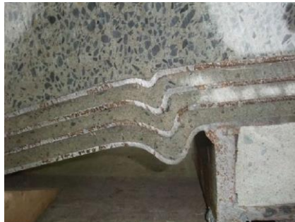
圧縮縁はらみ出し状況
