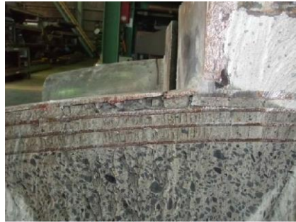
引張縁破断状況
