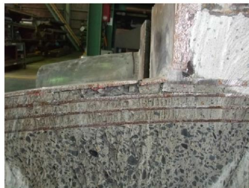
引張縁破断状況
