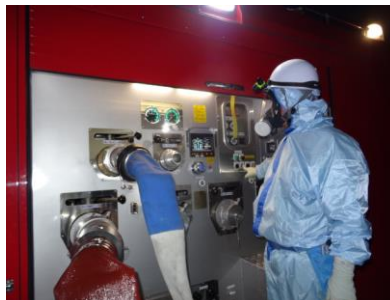
ポンプ起動操作（夜間）
