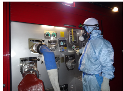
ポンプ起動操作（夜間）
