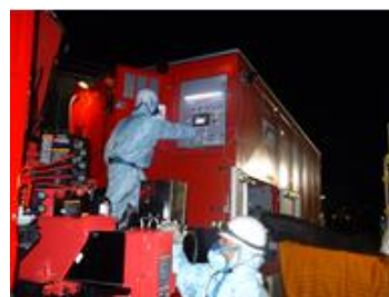
ポンプ起動操作（夜間）
