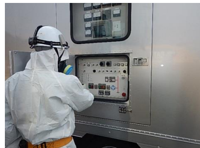
高圧発電機車での作業
