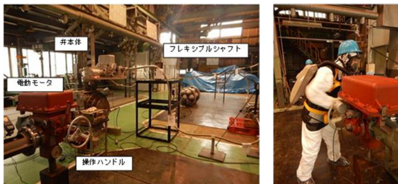
ベント操作（遠隔手動弁操作機構）
