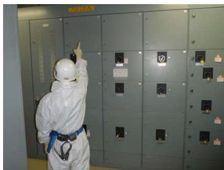
電源開放操作
