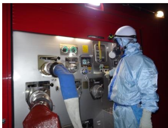
ポンプ起動操作（夜間）
