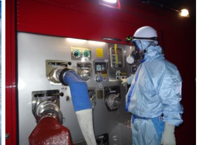
ポンプ起動操作（夜間）
