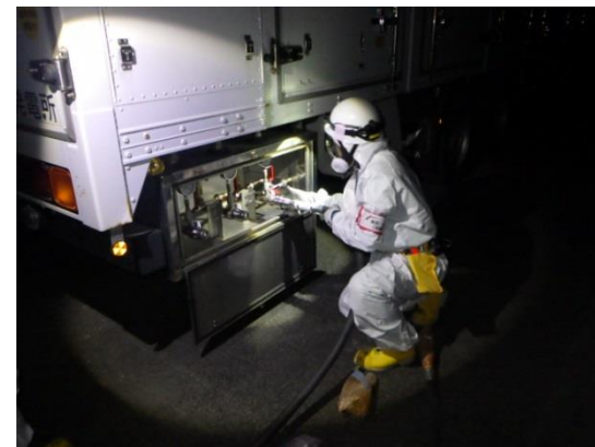
可搬式窒素供給装置 (EL15m 原子炉建物南側)
