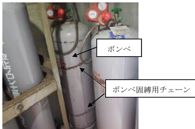
1・2号機 補助ボイラ室 補助ボイラ用プロパンガス
