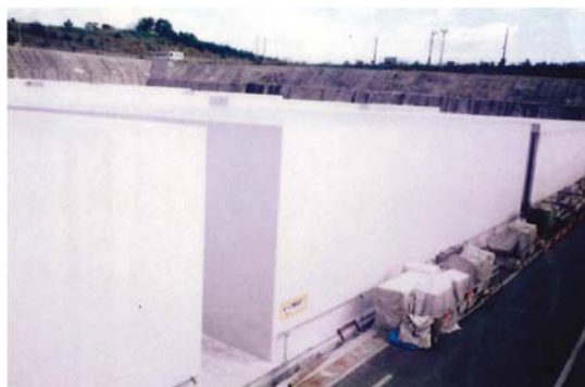
写真4 表面被覆状況(1号4-C)
