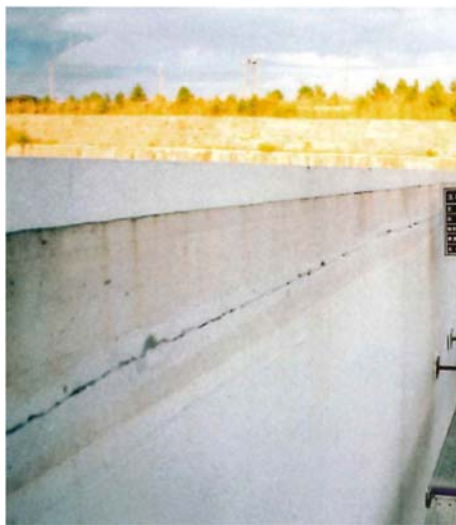
写真1 覆い側部のひび割れ状況
