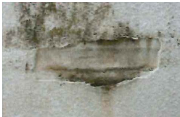
写真 10 表面被覆の剥離(1号 4-C 覆い側部)
