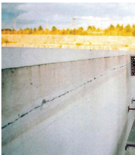
写真1 覆い側部のひび割れ状況
