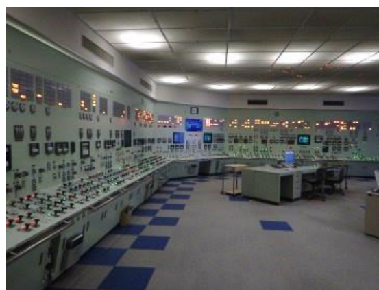
(直流非常灯点灯状態)
