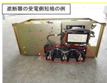
図 4.5.3 遮断器の短絡箇所 (C/C試験時)
