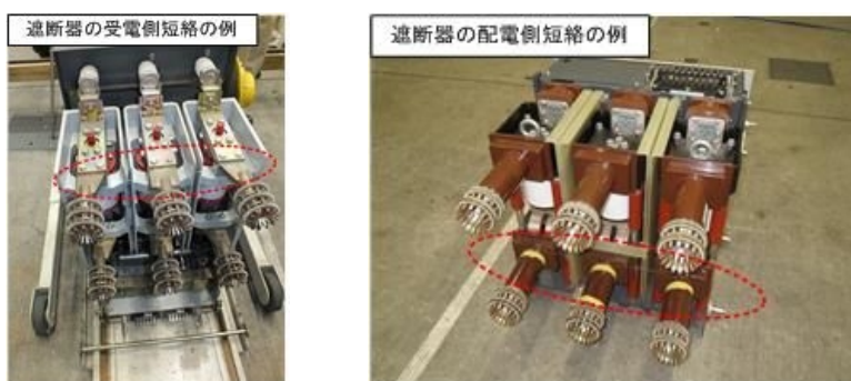
図 4.5.1 遮断器の短絡箇所 (M/C試験時)
