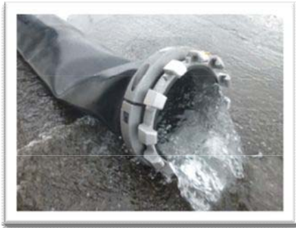
建屋外ホース接続箇所 (300A)
