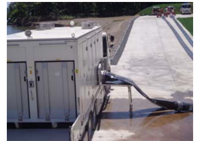
可搬型建屋外ホース接続 (300A)
