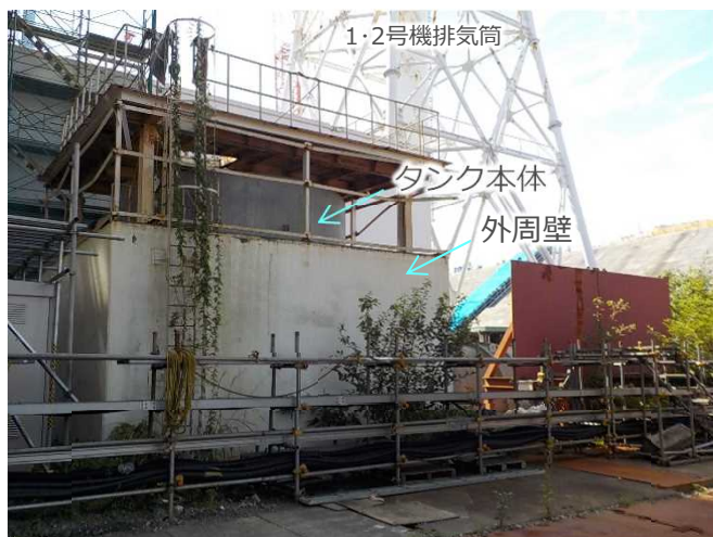
廃液サージタンク
